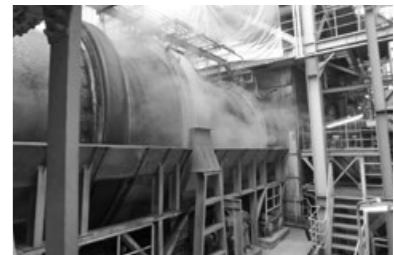
低濃度PCB廃棄物無害化処理システムの焼却溶解炉
